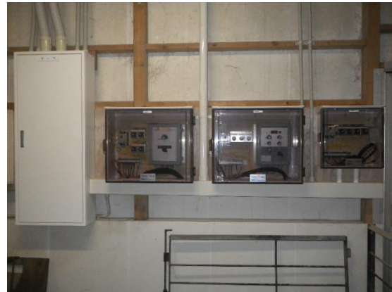
肥育舎脱臭システム 制御盤
