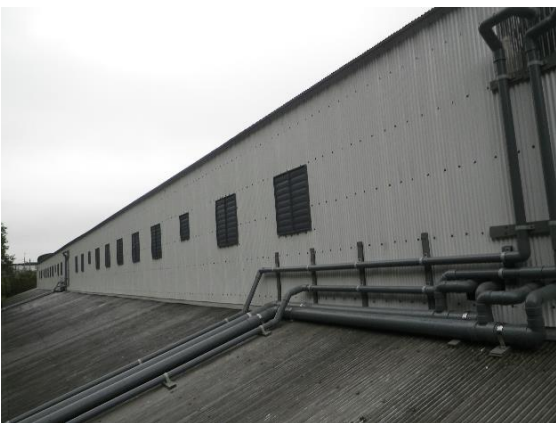
肥育舎脱臭システム導入後
