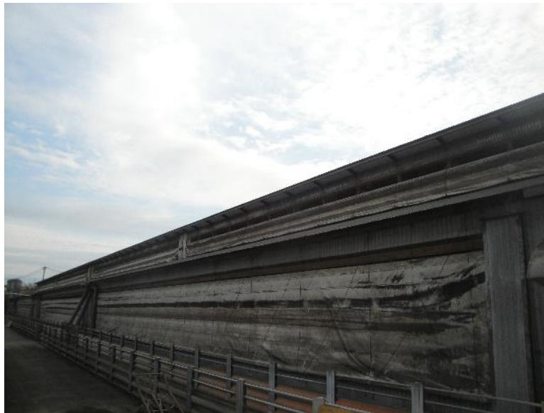
肥育舎脱臭システム導入前
