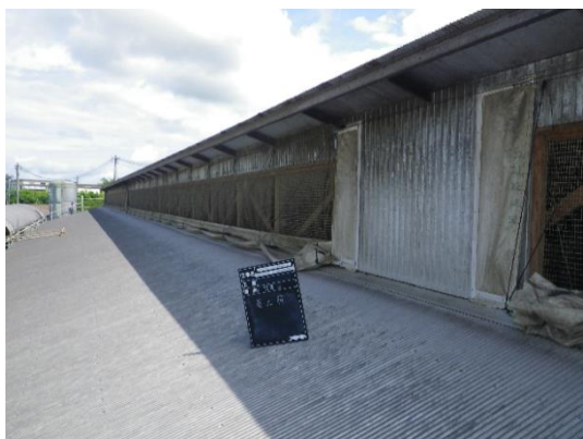
肥育舎脱臭システム導入前
